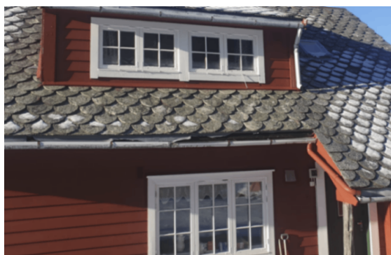
Slitasje på takrenner og beslag.
