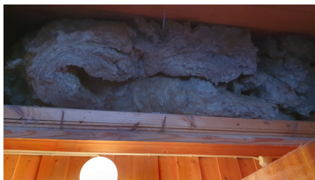
Manglende luftesjikt i tak.
