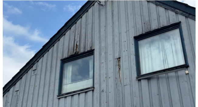
Bilde viser eksempel på høy slitasje, med behov for utbedringer.
