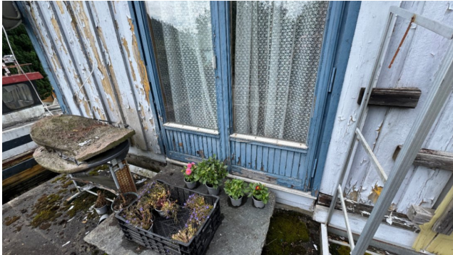
Bilde viser eksempel på ytterdør med behov for utskifting.
