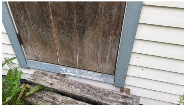
Det er åpning mellom ytterdør og terreng, må utbedres.
