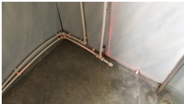
Fuktskade i veggplater i dusjsone.
