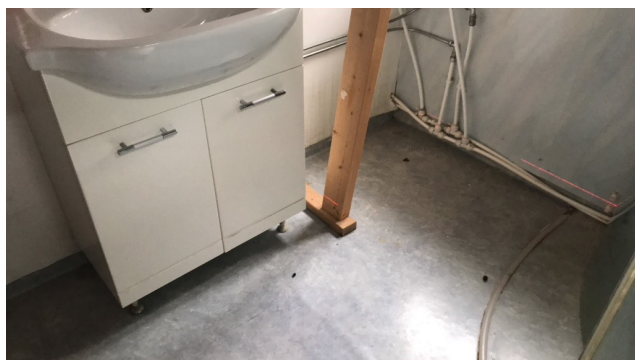
Hull/gjennomføring i gulv i våtsone
