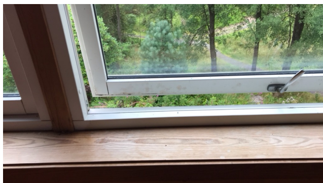
Flere av vinduene er treg å åpne/lukke.
