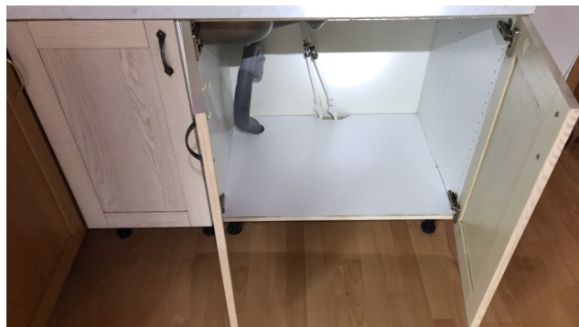
Oppsvulmet bunnplate i benkeskap.
