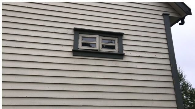
Det må påregnes utbedring av ytre tetting på enkelte vinduer.
