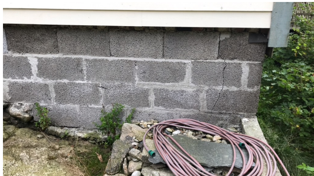
Sprekk i grunnmur.
