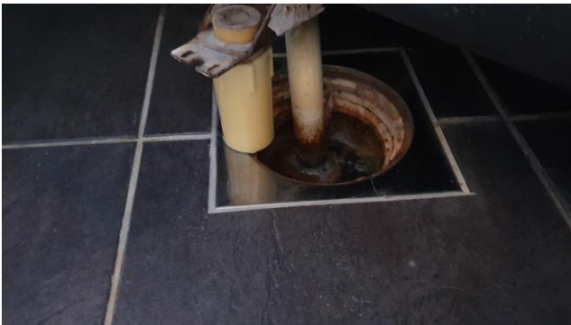
Opprinnelig støpejernssluk, lekkasjer kan lett oppstå i overgang badegulv og sluk.
