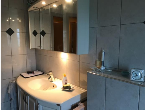
Sanitærutstyr med vegghegt toalett, badekar og innredning m/servant. Speilskap montert på vegg.
