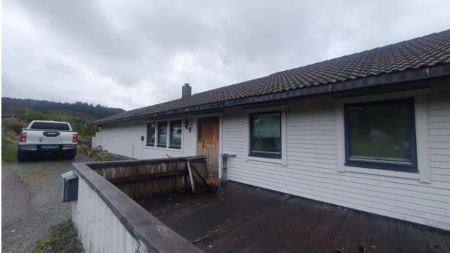
Terrasse trenger vedlikehold.
