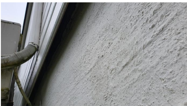
Mangler musebånd på gavlvegg.
