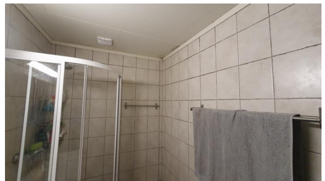
Vifte på bad er defekt.
