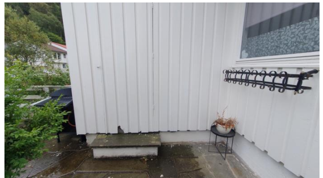
Lokal råteskade på boddør.
