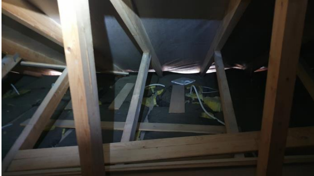
Isolasjon og papp er stedvis skadet/avrevet og må utbedres.
