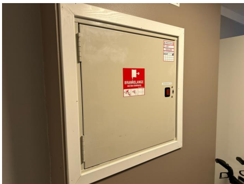
Felles brannslange i bygningen.
