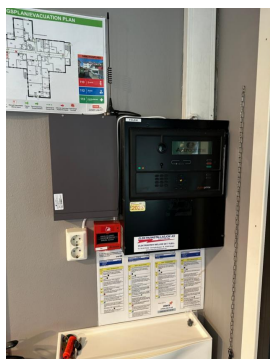
Felles brannalarmanlegg i bygningen.
